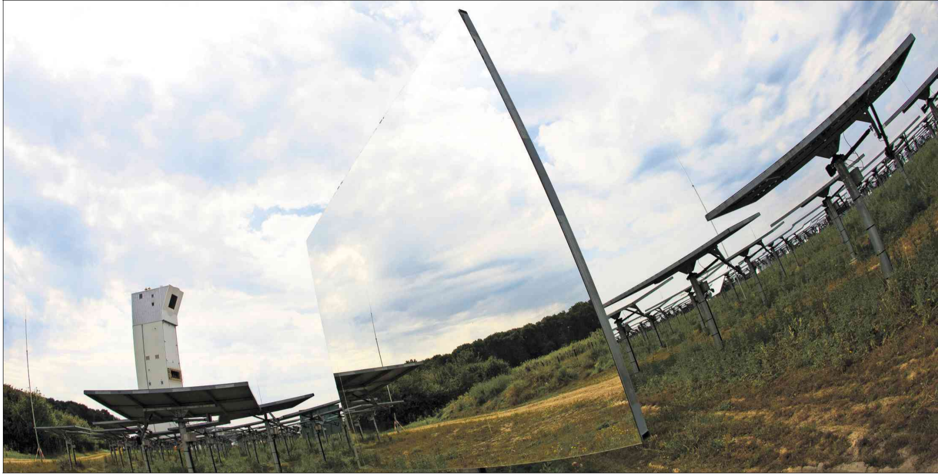
Software kann bei der Energiewende helfen, zum Beispiel bei der Steuerung der Spiegel in einem Solarkraftwerk (im Bild: Versuchskraftwerk Jülich). Foto: picture-alliance/dpa/Rolf Vennenbernd
